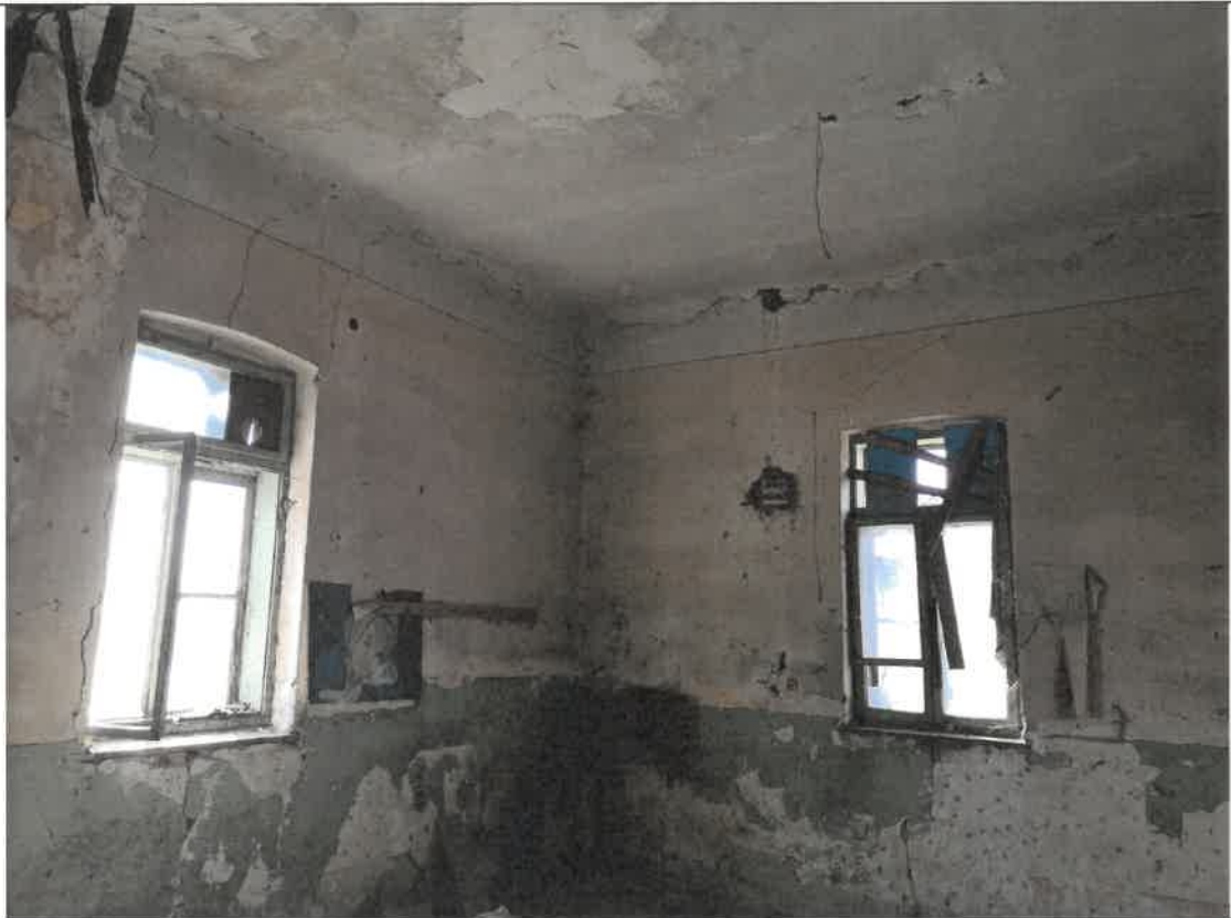
Foto 12. Interior – degradari severe
