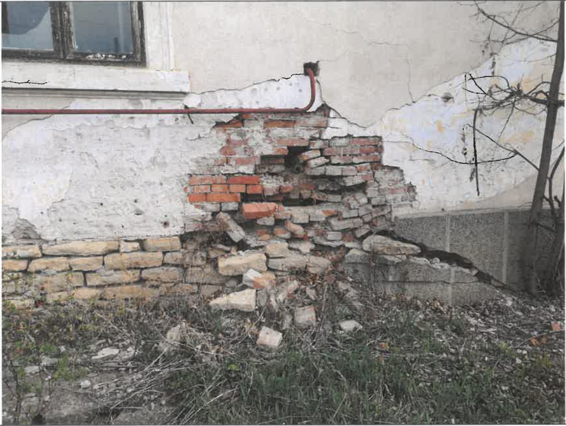
Foto 19. Degradari severe pereti exteriori si fundatii din piatra
