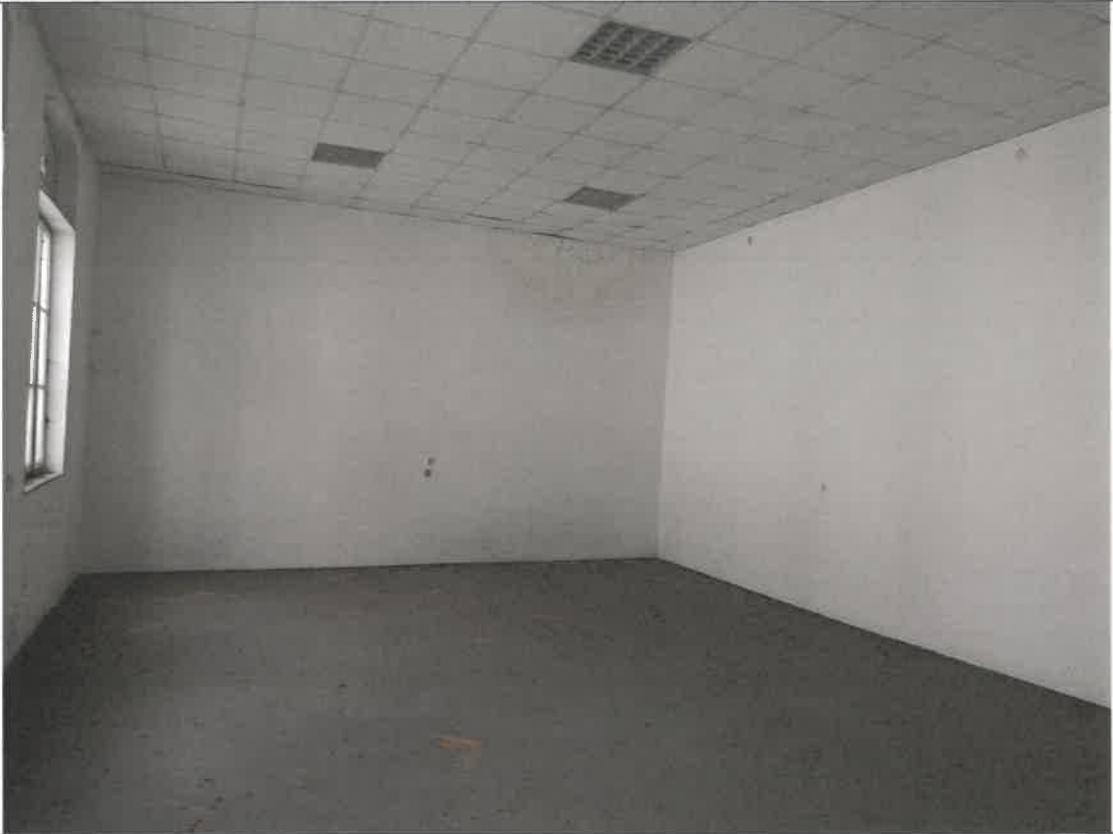
Foto 17. Interior – degradari finisaje
