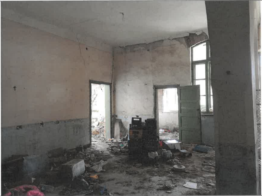
Foto 13. Interior – degradari severe
