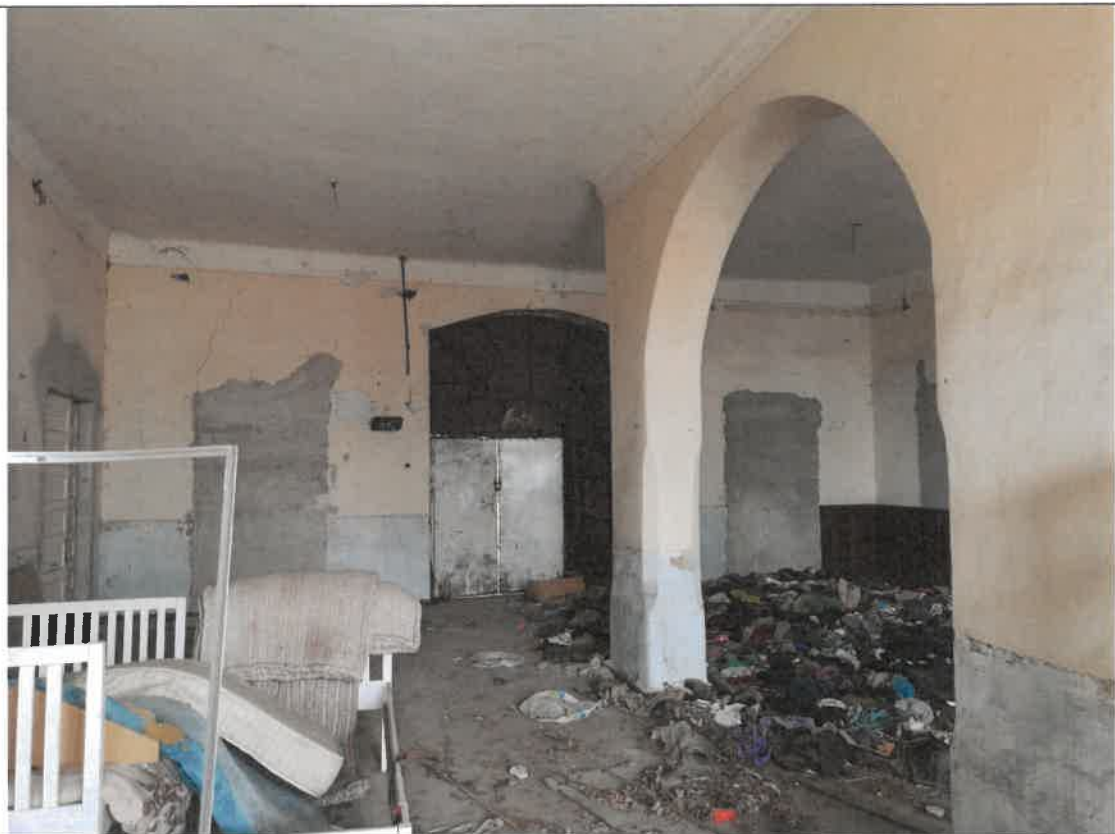
Foto 10. Interior – degradari severe
