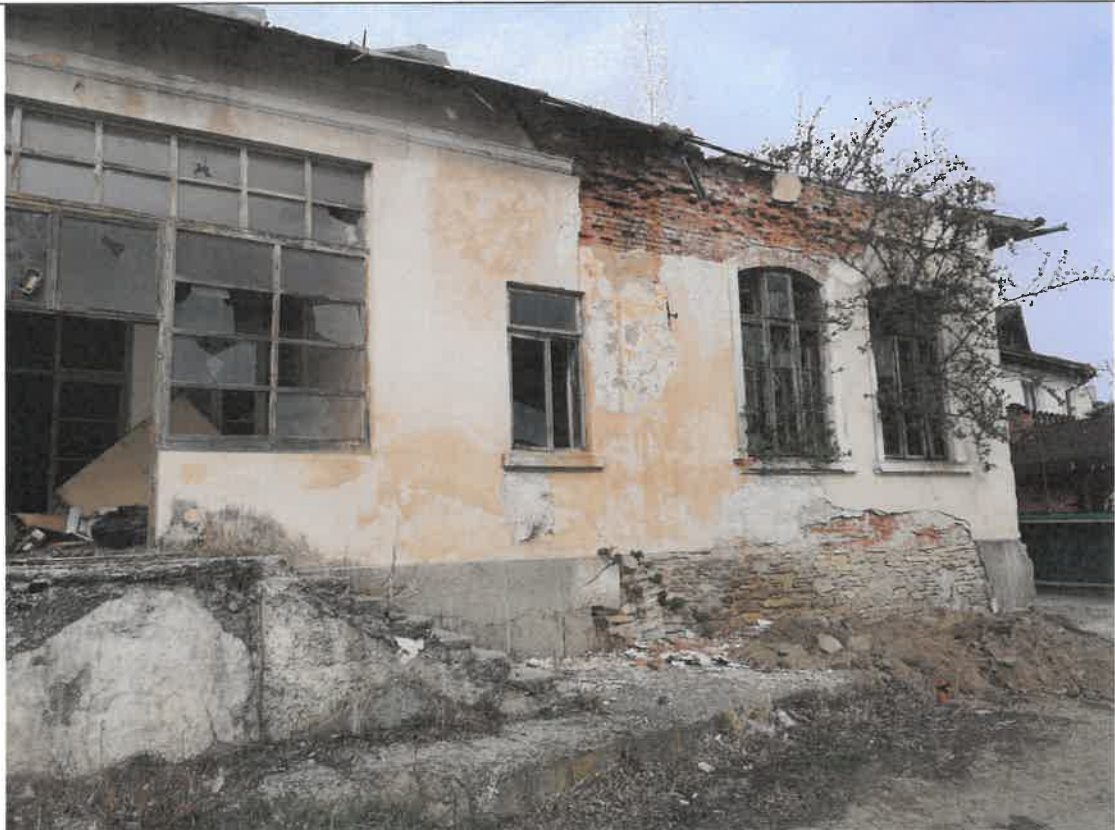
Foto 8. Fatada posterioara– degradari severe pereti
