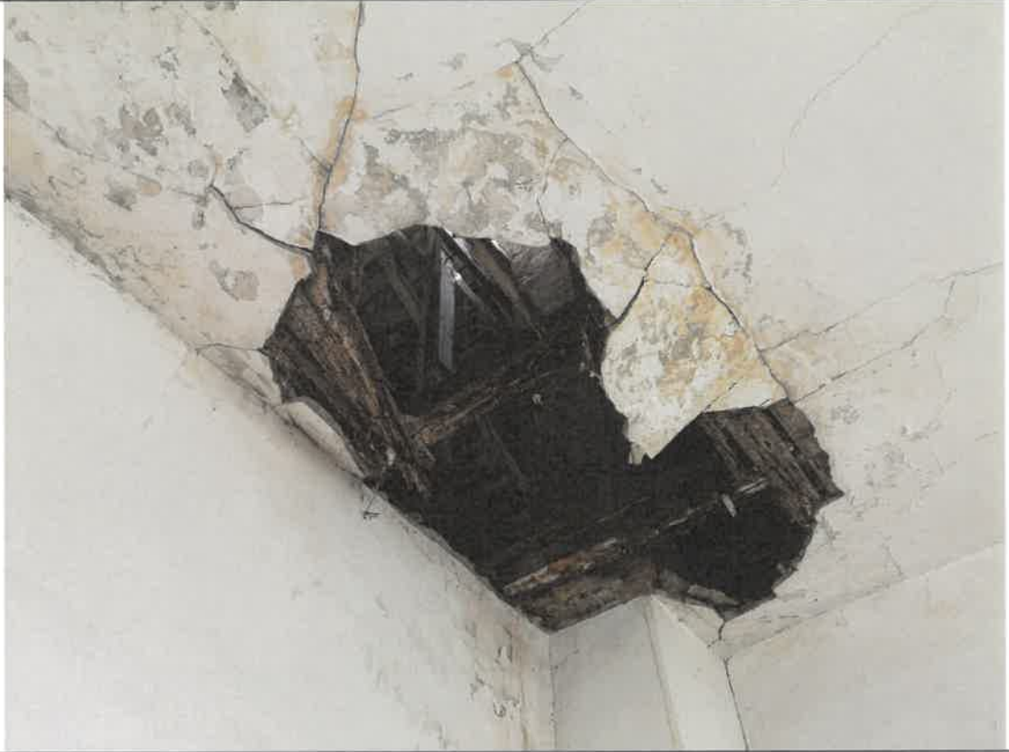
Foto 15. Interior – degradari severe la planseu
