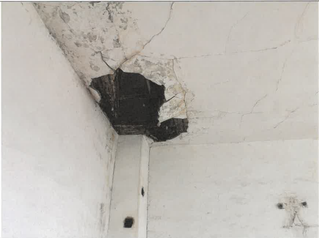
Foto 18. Interior – degradari severe planseu
