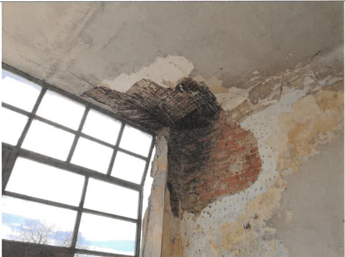
Foto 16. Interior – degradari severe
