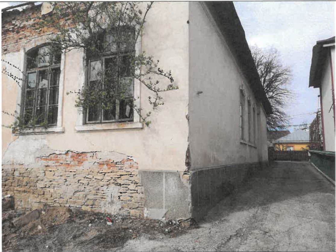
Foto 9. Fatada laterala stanga– degradari severe pereti
