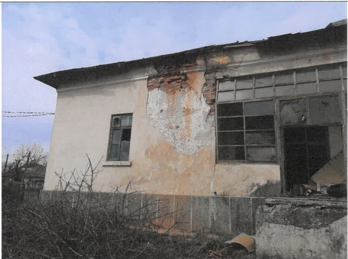
Foto 6. Fatada posterioara – degradari severe pereti
