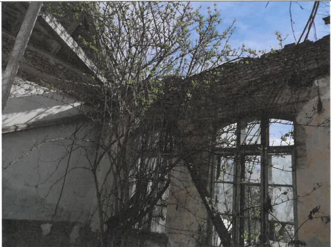
Foto 14. Interior – Zona cu acoperis si planseu prabusite
