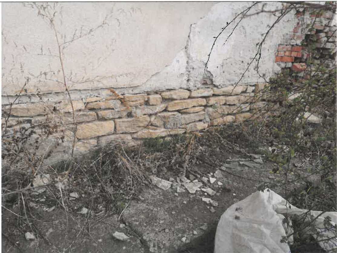
Foto 20. Degradari severe pereti exteriori si fundatii din piatra
