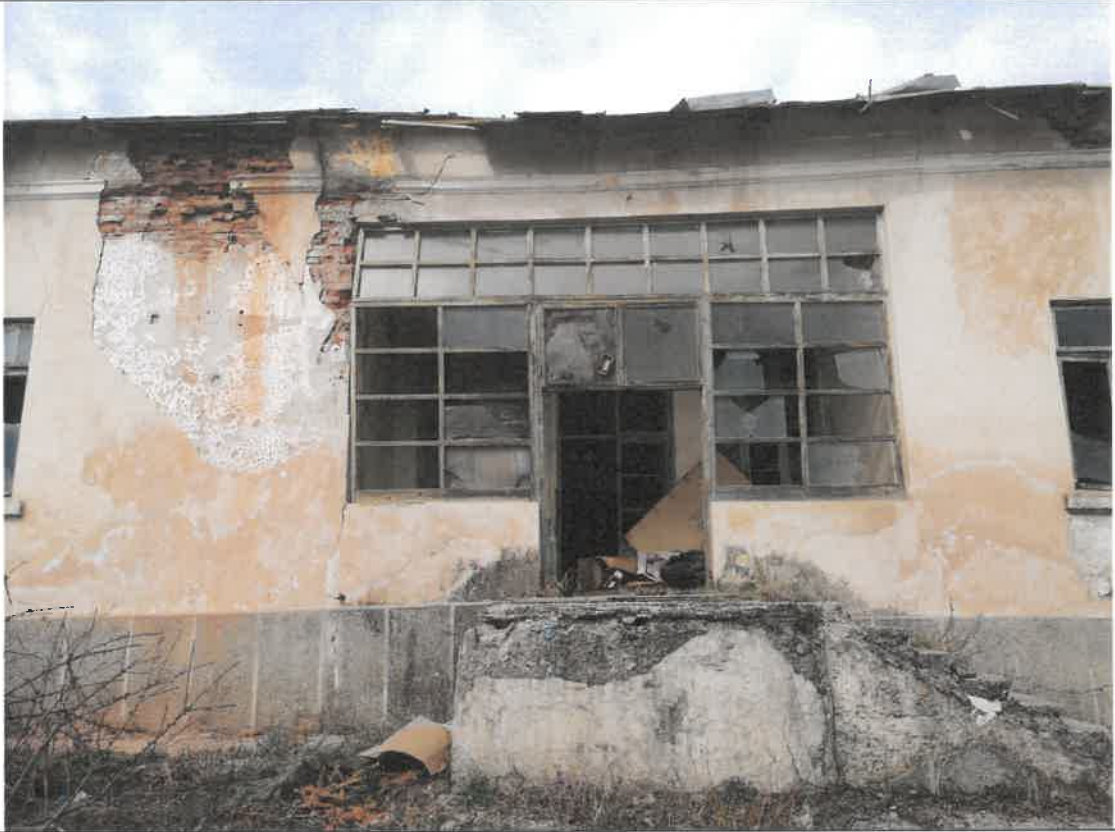
Foto 7. Fatada posterioara– degradari severe pereti
